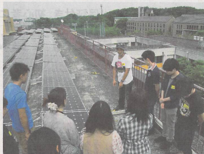
恵泉女学園大一部校舎の屋根に設置した太陽光発電パネル。学生たちは多摩循環型エネルギー協会の人材育成事業に参加し、施工技術などの説明に熱心に耳を傾けた—東京都多摩市
